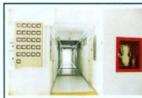
อุปกรณ์ดับเพลิง
